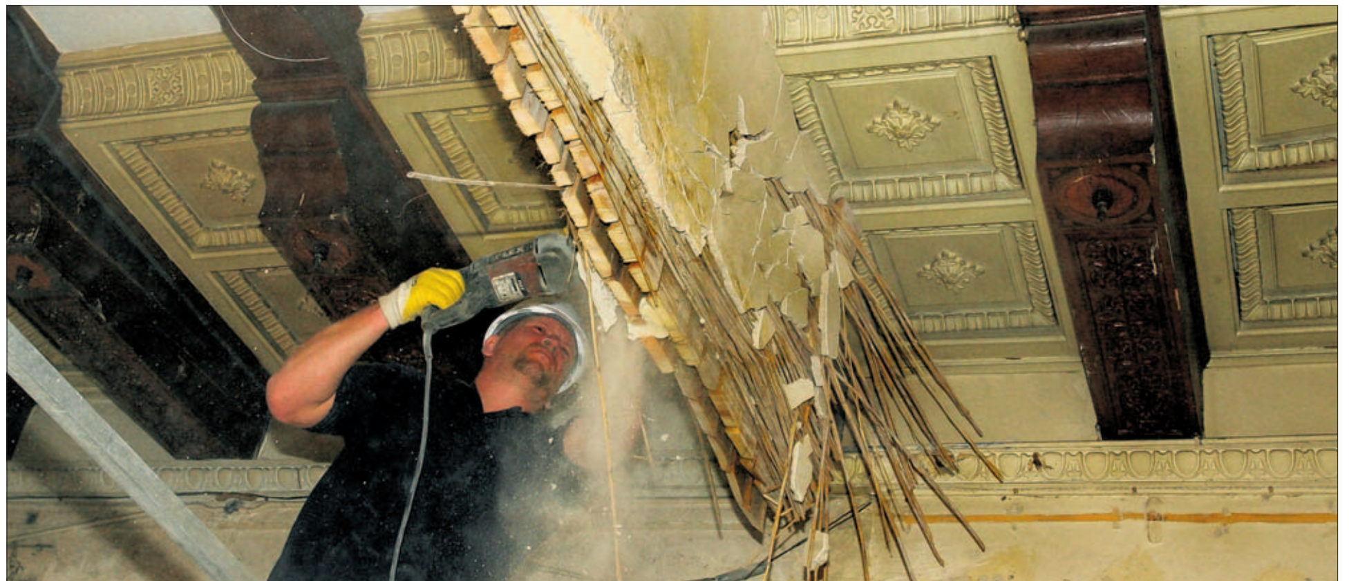
Bei den Abrissarbeiten im Konzilzimmer müssen die Bauleute der Spezialfirma Lehwald aus Schwaan – hier Mirko Kriewe bei der Arbeit – äußerst umsichtig vorgehen, um die wertvollen hölzernen Deckenbalken nicht zu beschädigen. Foto: Hartmut Klonowski
